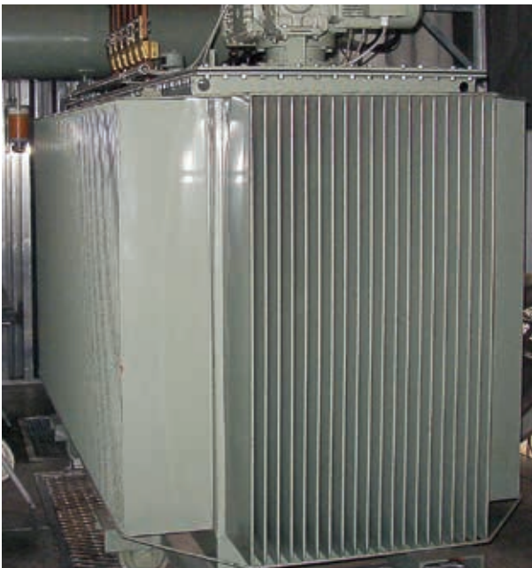
Coolant fins / radiators
